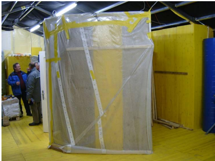
Schleuse mit Zugang zum Mannloch
